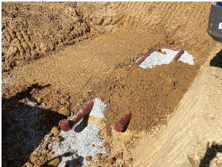
Erdkollektor für die Ansaugung von Frischluft
