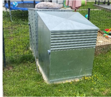
Filterkasten bei Ansaugung von Frischluft
