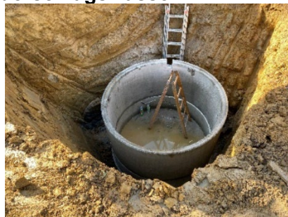
Regenwassertank aus Betonringen
